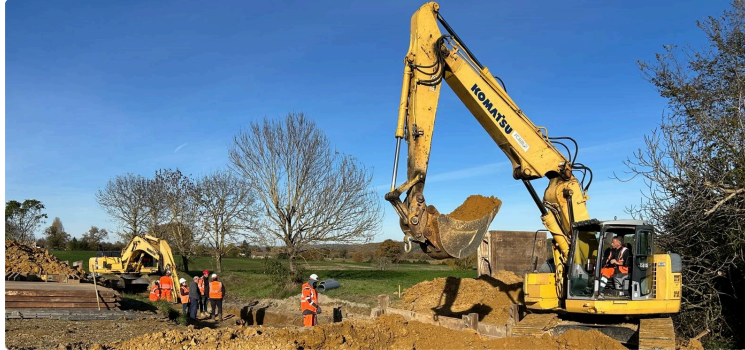
Le premier acte de la rénovation du réseau d'assainissement de la commune de Miélan.
