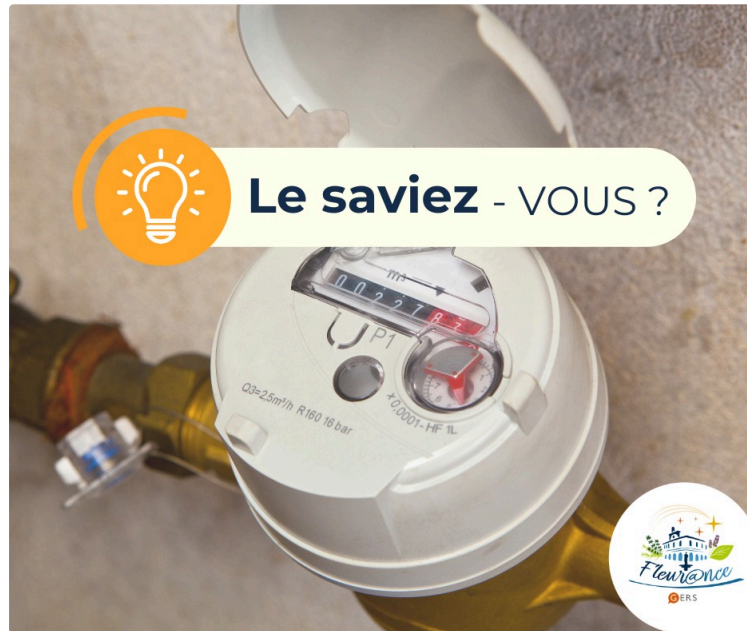
Gel : attention aux fuites d'eau
