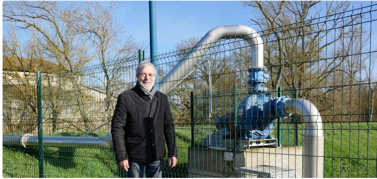
Au sec grâce à la pompe !
